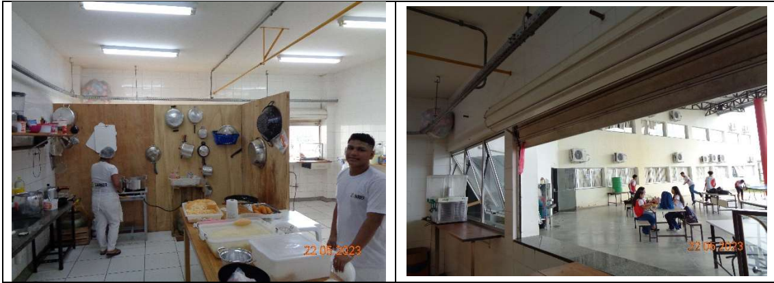
Imagem: Fotos retiradas no Campus Sena Madureira em 22/05/2023 onde podemos verificar que a cozinha é conjugada com a cantina e com a despensa, além perceber a inexistência de exaustores e telas mosquiteiros.
