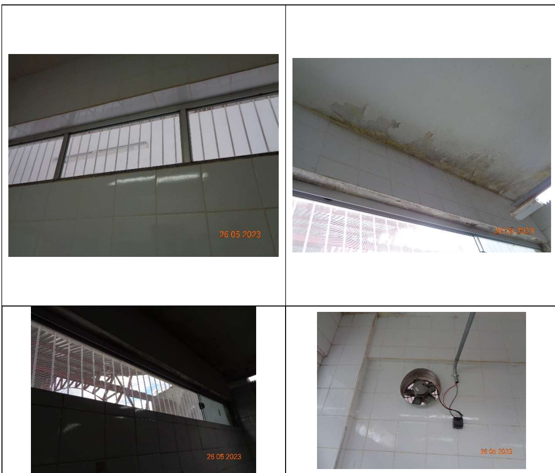
Imagem: Fotos retiradas no Campus Xapuri em 26/05/2023, onde podemos verificar: a) na despensa, as janelas ficam fechadas e não possuem telas mosquiteiros; b) na cozinha, apesar da existência de janelas com telas mosquiteiros e um exaustor, podemos verificar uma humidade avançada no forro que fica em cima da bancada.
