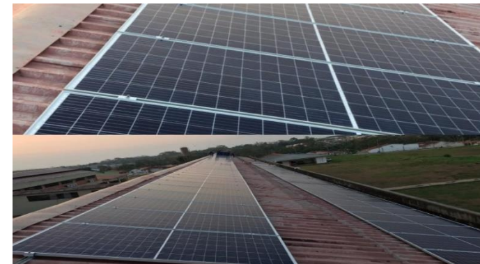
FIGURA 24: IMPLANTAÇÃO DE GERADORES DE ENERGIA SOLAR FOTOVOLTAICOS NO CAMPUS RIO BRANCO
