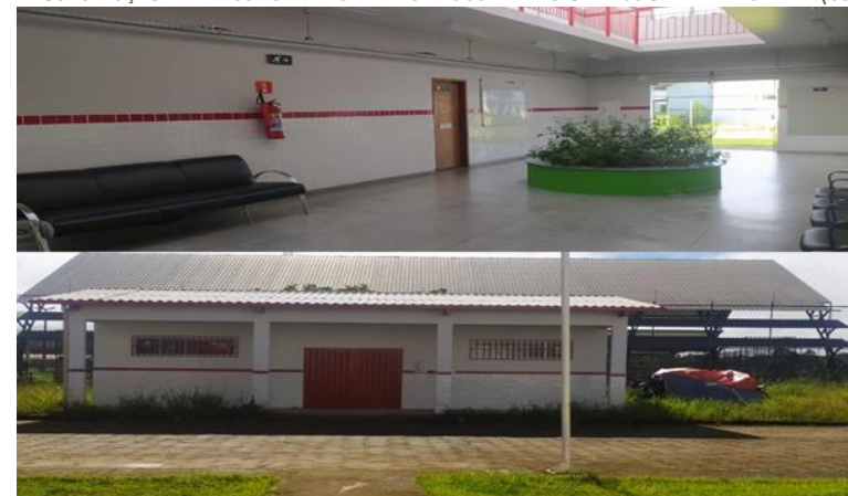
FIGURA 12: - CONSTRUÇÃO DE DEPÓSITO E REFORMA DO BLOCO “A” DO CAMPUS SENNA MADUREIRA (CONCLUÍDA)
