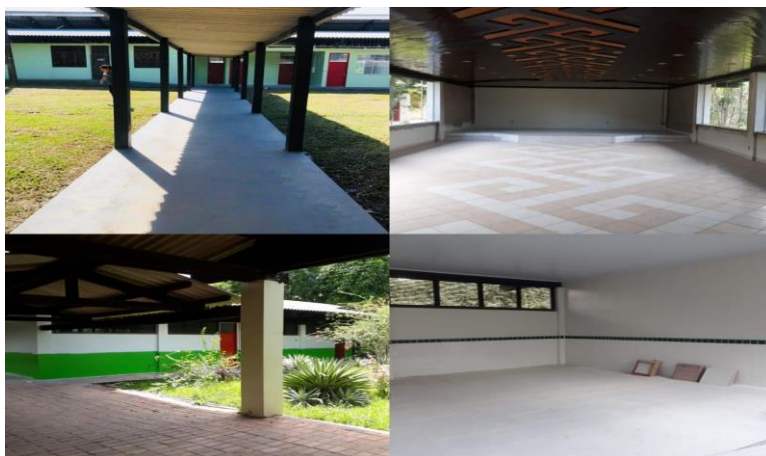
FIGURA 14: 2ª FASE (REFORMA DO REFEITÓRIO, GUARITA, AUDITÓRIO E CONCLUSÃO DAS CALCADAS EXTERNAS) – CONCLUÍDA.
